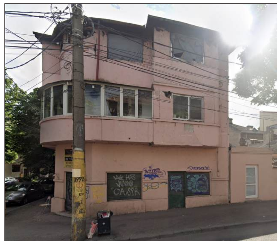
strada Sabinelor, nr. 2 Supraetajări și închideri improvizate ale teraselor și golurilor
