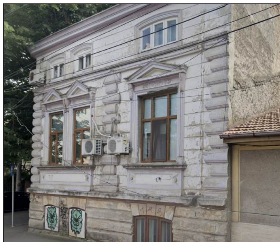
strada Dacia, nr. 32 Fisuri ale tencuielii și degradări la nivelul ancadramentelor și elementelor decorative
