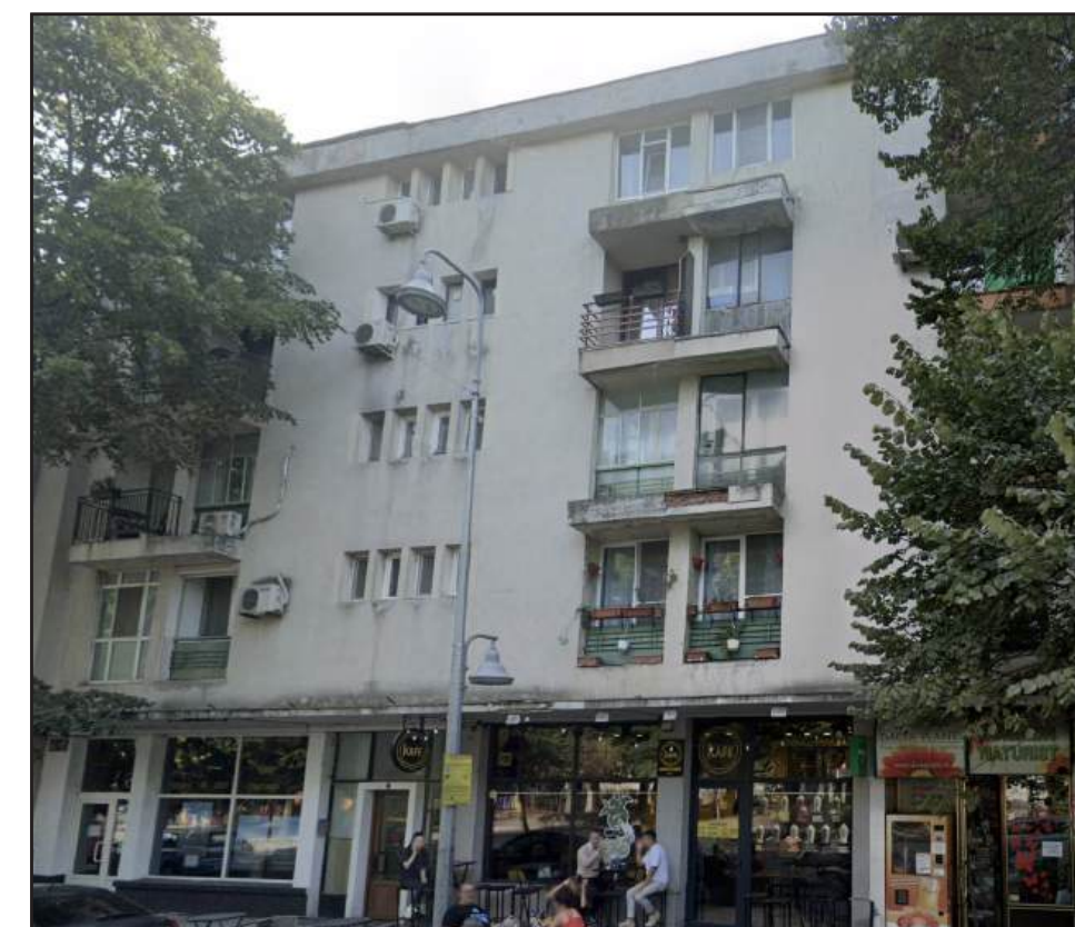
Bd Tomis, nr. 97 Fisuri ale tencuielii la nivelul fațadelor, decolorării ale tencuielii, degradări la nivelul balcoanelor
